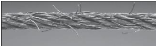
Câble Avec Câble de Corrosion
